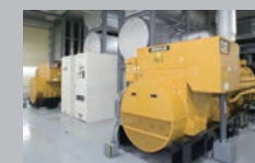
非常用発電設備
