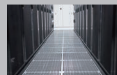
冷気吹き出し口
